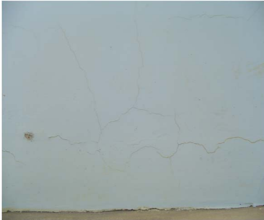
Figura 27 – Fissura por retração
