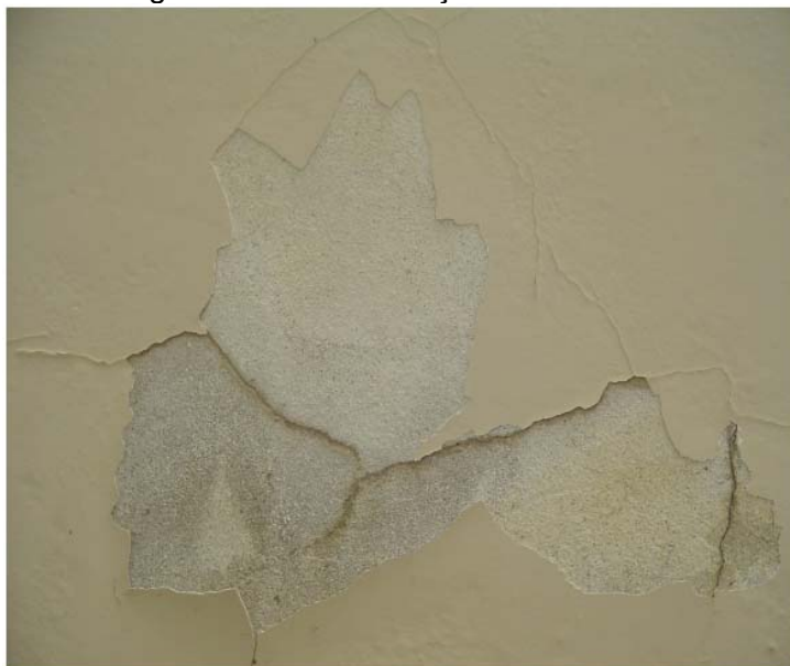
Figura 05 – Fissura e Fendilhamento da Pintura
