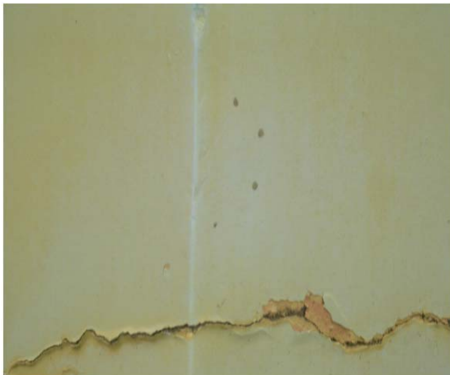
Figura 16 – Fissura em alvenaria
