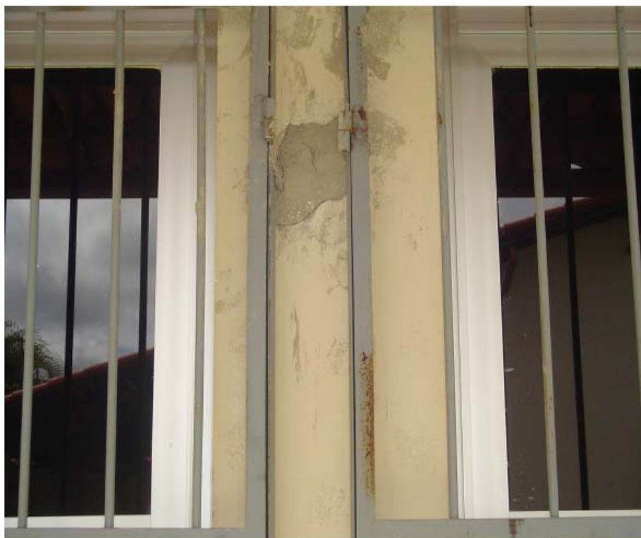
Figura 18– Vista das grades
