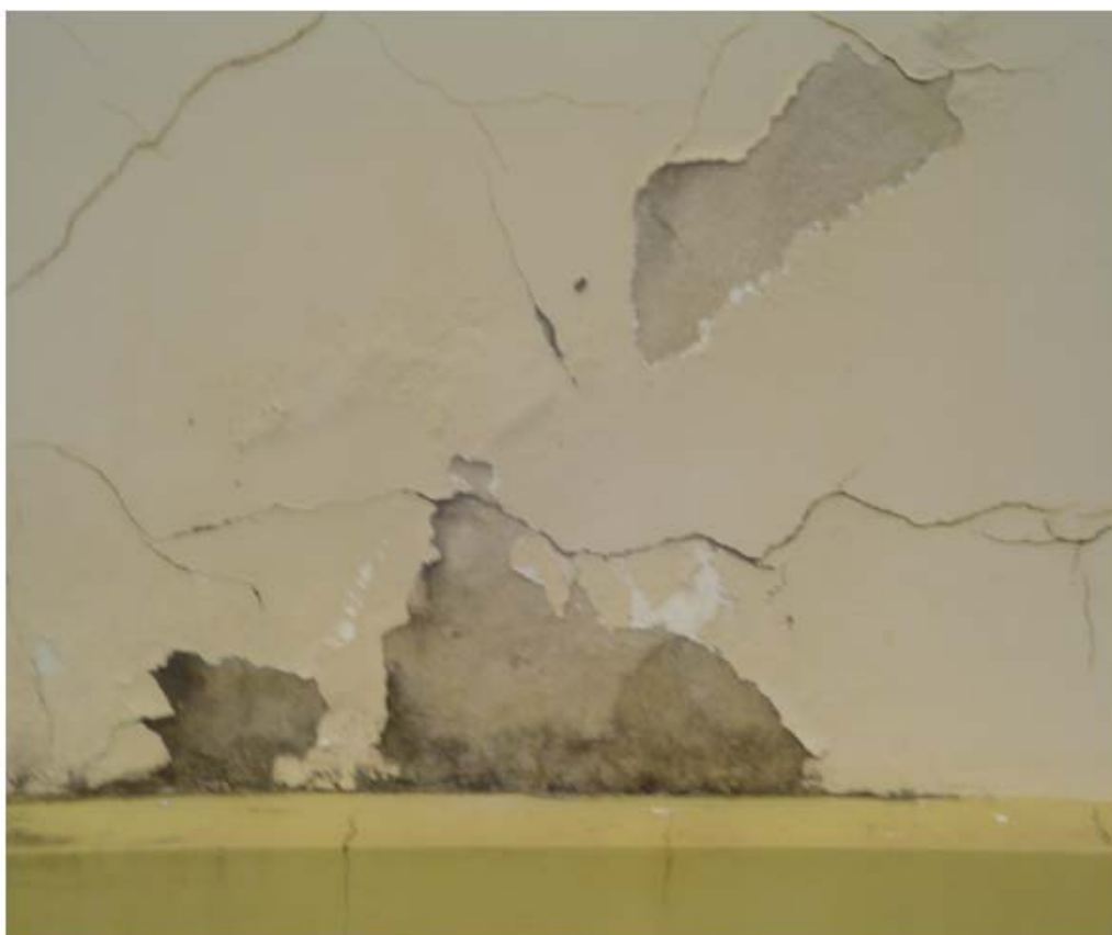
Figura 12 – Deslocamento de pintura
