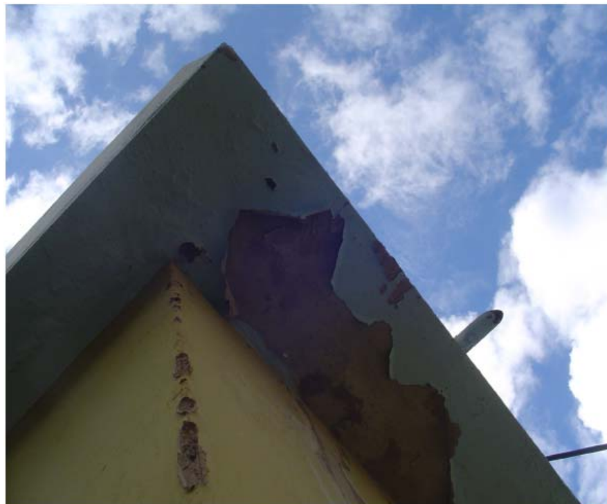
Figura 25 – Fundo da laje da cozinha
