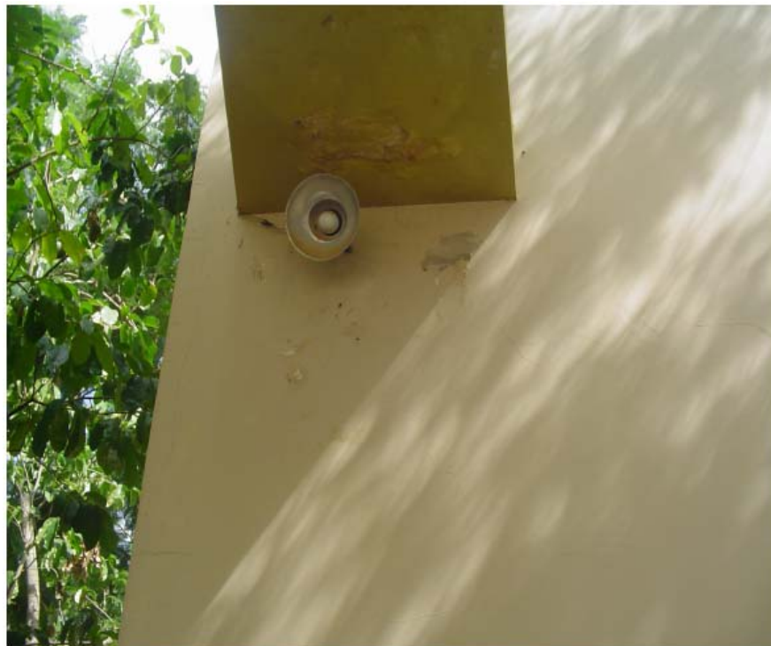
Figura 23 – Fundo da calha saponificação
