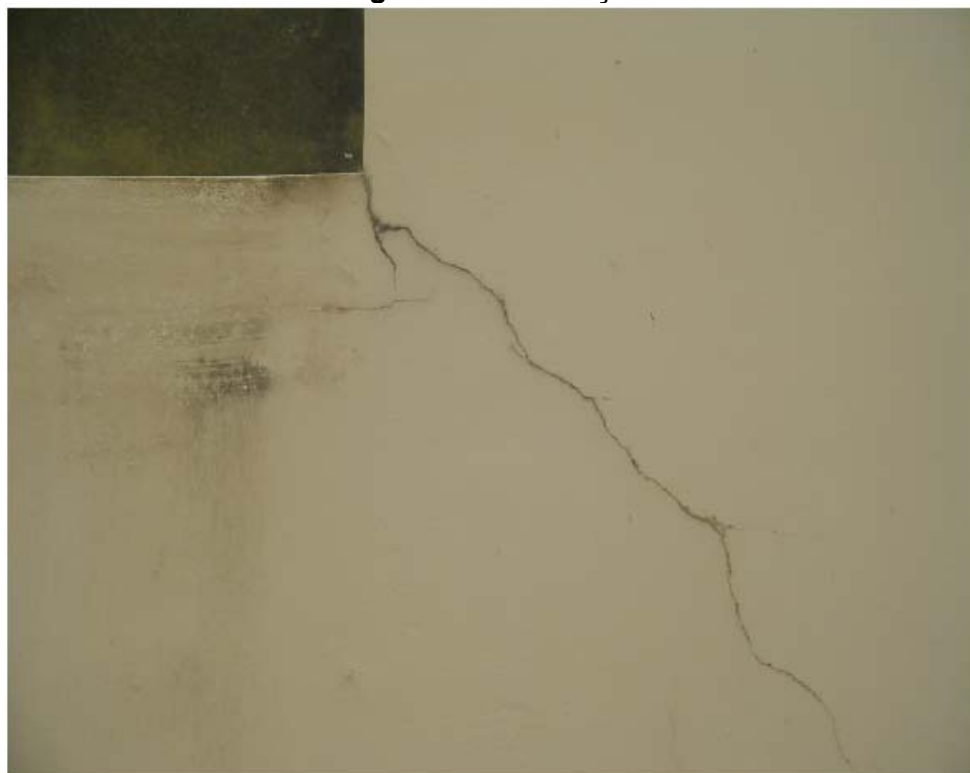
Figura 04– Fissura Falta de Verga
