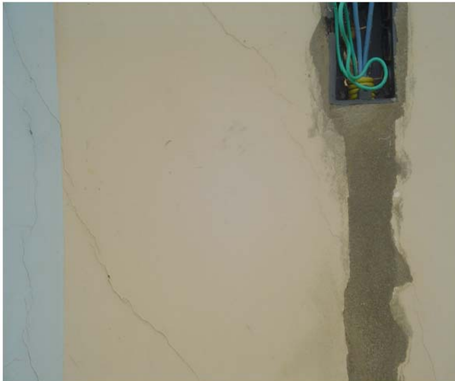
Figura 15 – Fiação sem acabamento
